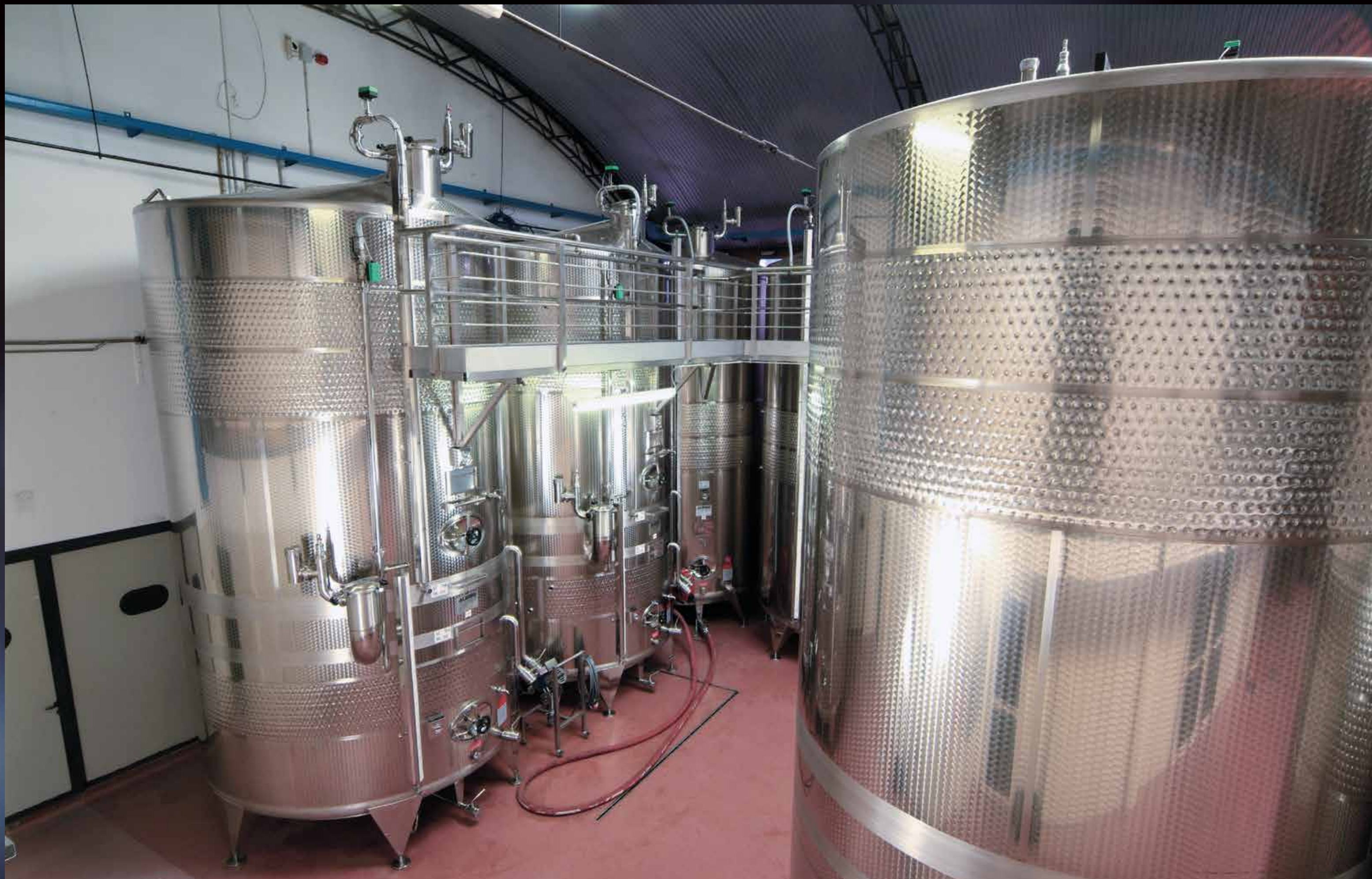
Politank Termo da hl 100 + hl 200 e Termotank da hl 200 termocondizionati con Termostar, impianto di lavaggio Cleanfix e Innergas
