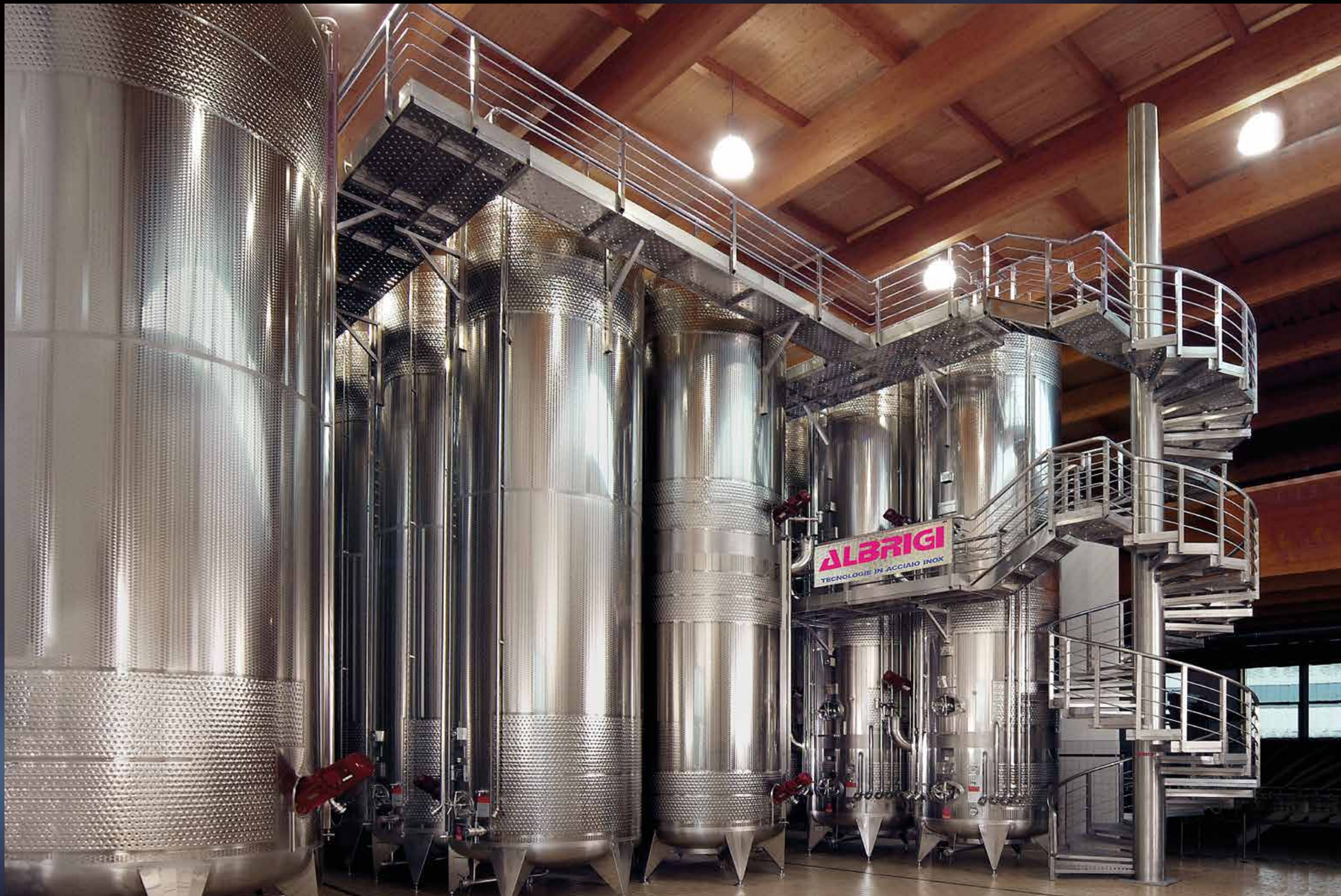
Cantina di stoccaggio composta da Bigtank Termo (da hl 600 e hl 300) e Politank Termo (da hl 150 + 150 e hl 200 + 100 e hl 50 + 50 + 100) tutti completi di condizionamento Termostar, impianto di lavaggio Cleanfix e Innergas
