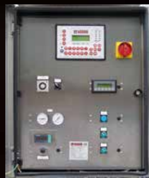
Quadro elettrico per follatore
