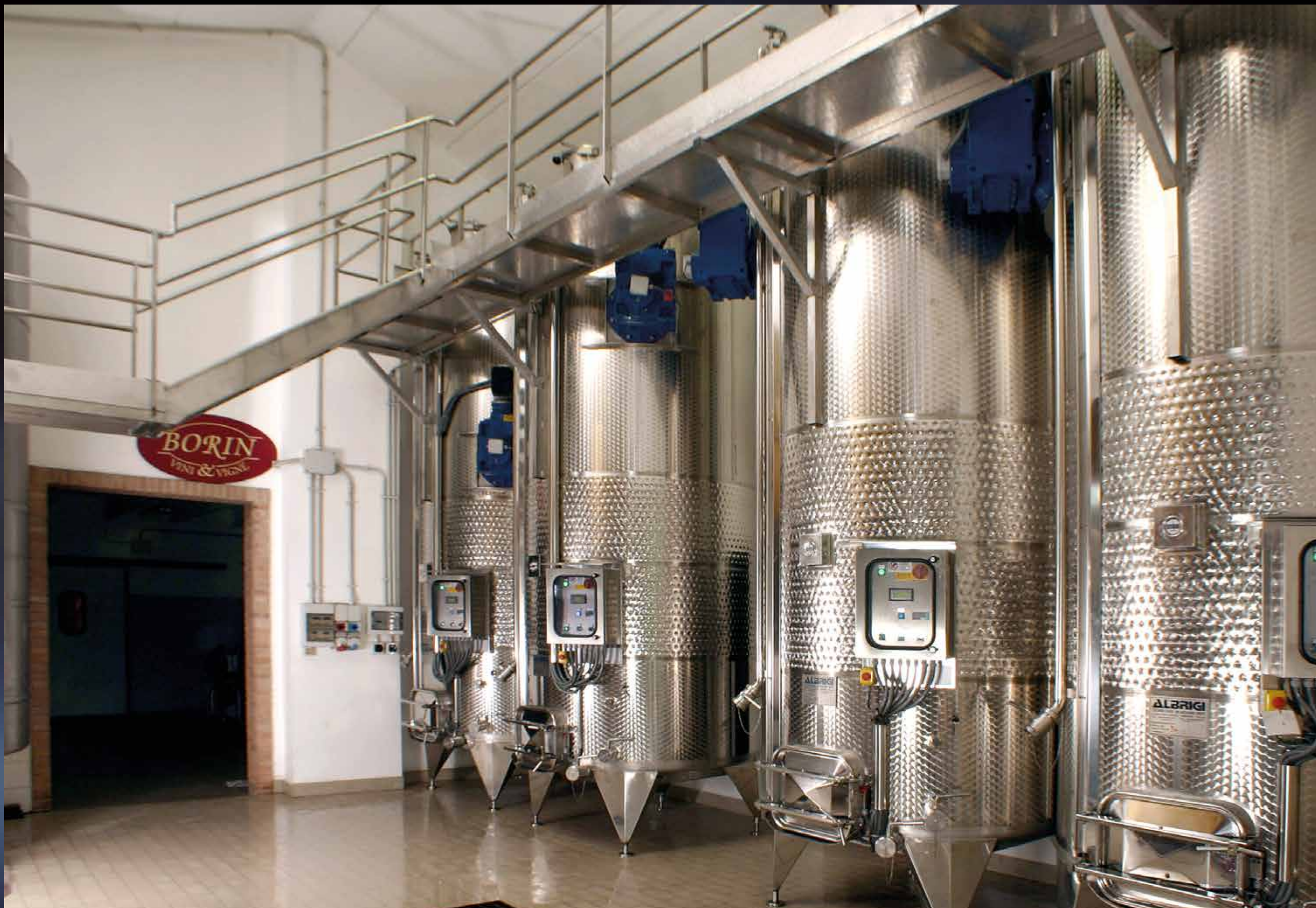
Cantina con Volvotank da hl 100 termocondizionati con Termostar e impianto di lavaggio Cleanfix
