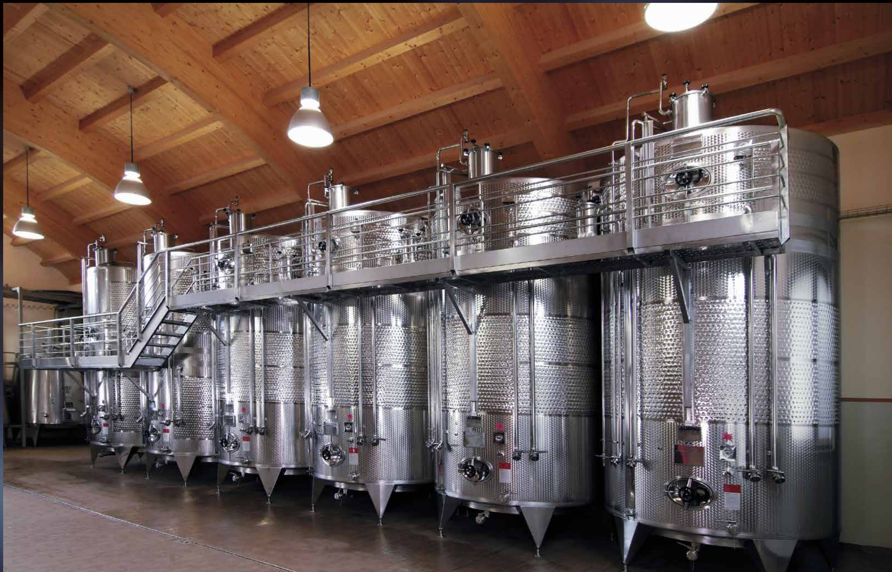
Politank Termo da hl 150 + hl 50 termocondizionati con Termostar, impianto di lavaggio Cleanfix e Innergas
