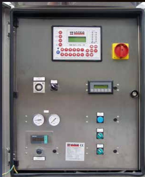
Quadro con la centralina di ossigenazione
