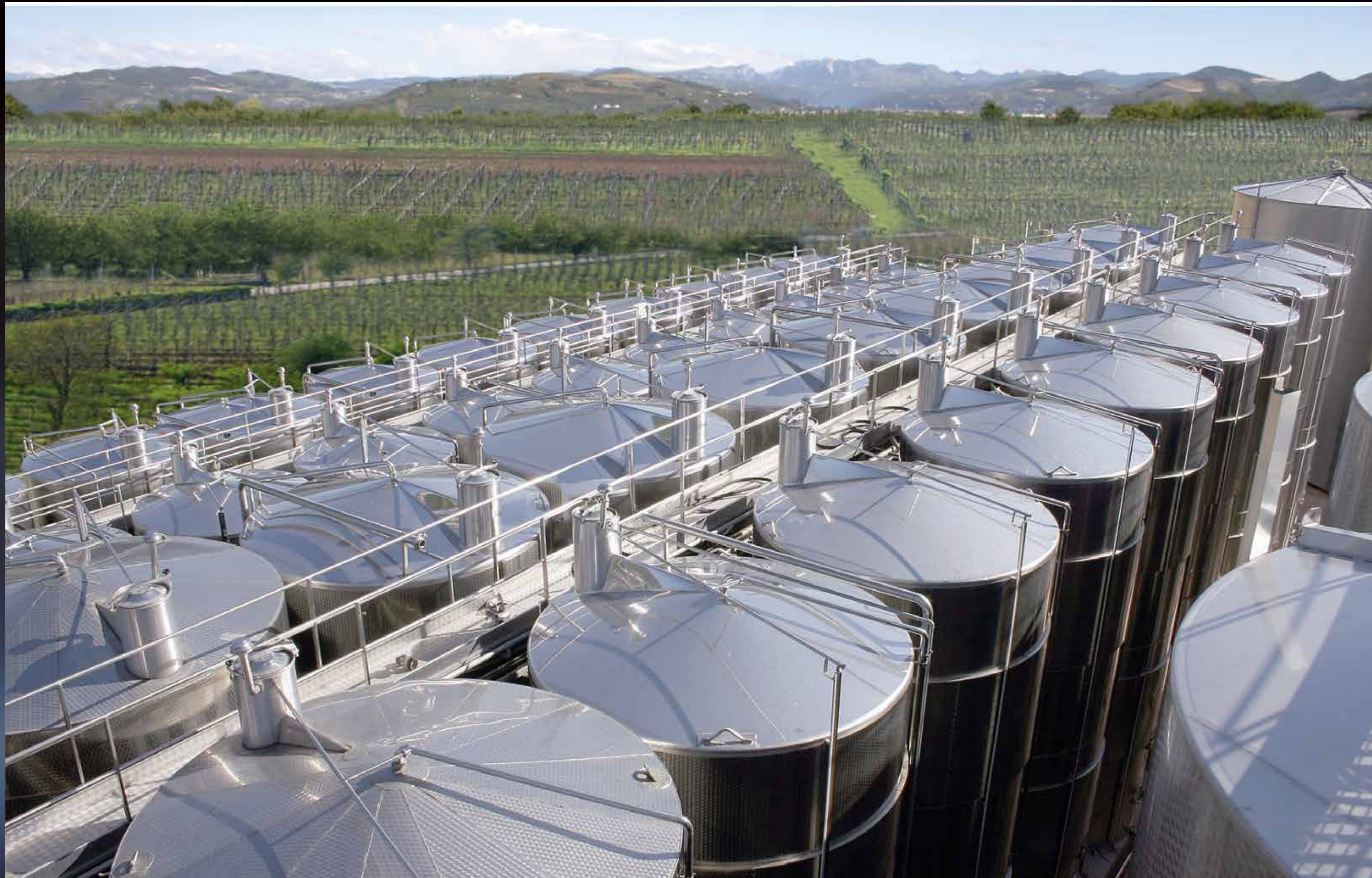
Batteria di Megatank da hl 600 e Bigtank da hl 300 termocondizionati con Termostar Double e impianto di lavaggio fisso Cleanfix
