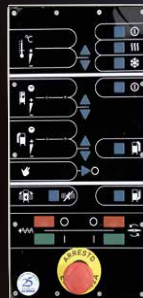
Quadro di comando con P.L.C.
