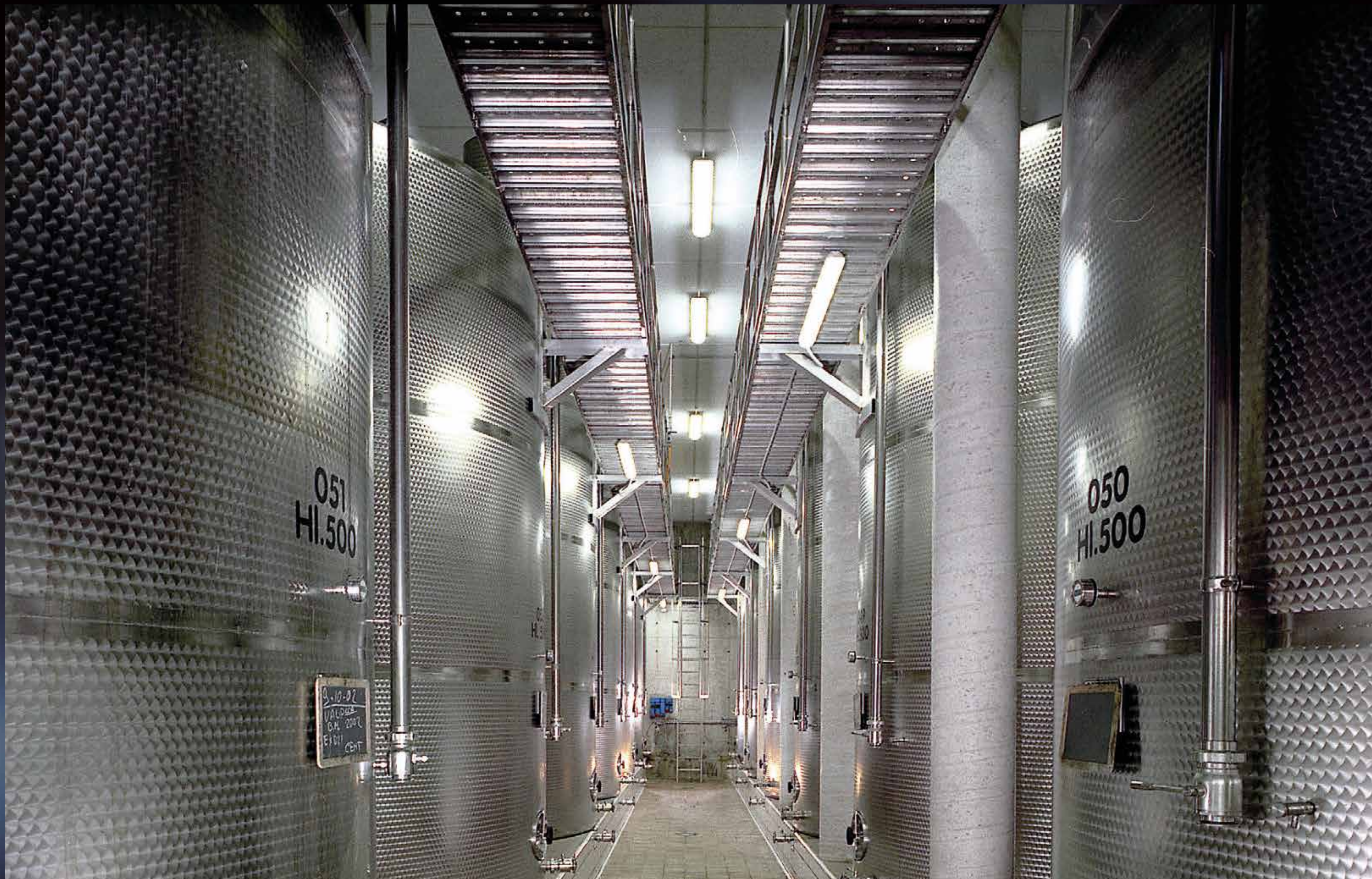
Cantina con n° 24 Megatank da hl 500 per stoccaggio vini
