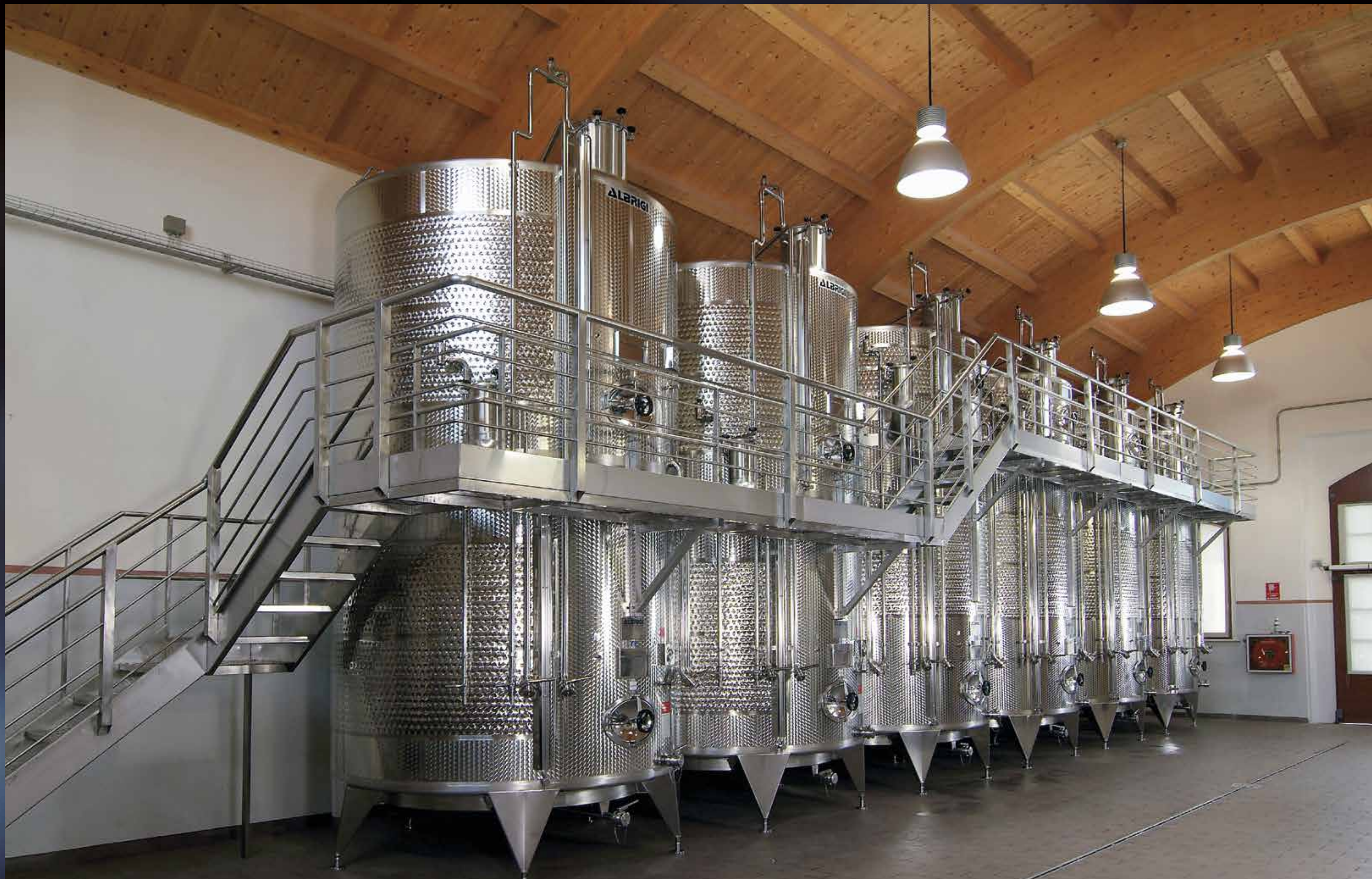
Politank Termo da hl 100 + hl 100 termocondizionato con Termostar, impianto di lavaggio Cleanfix e Innergas
