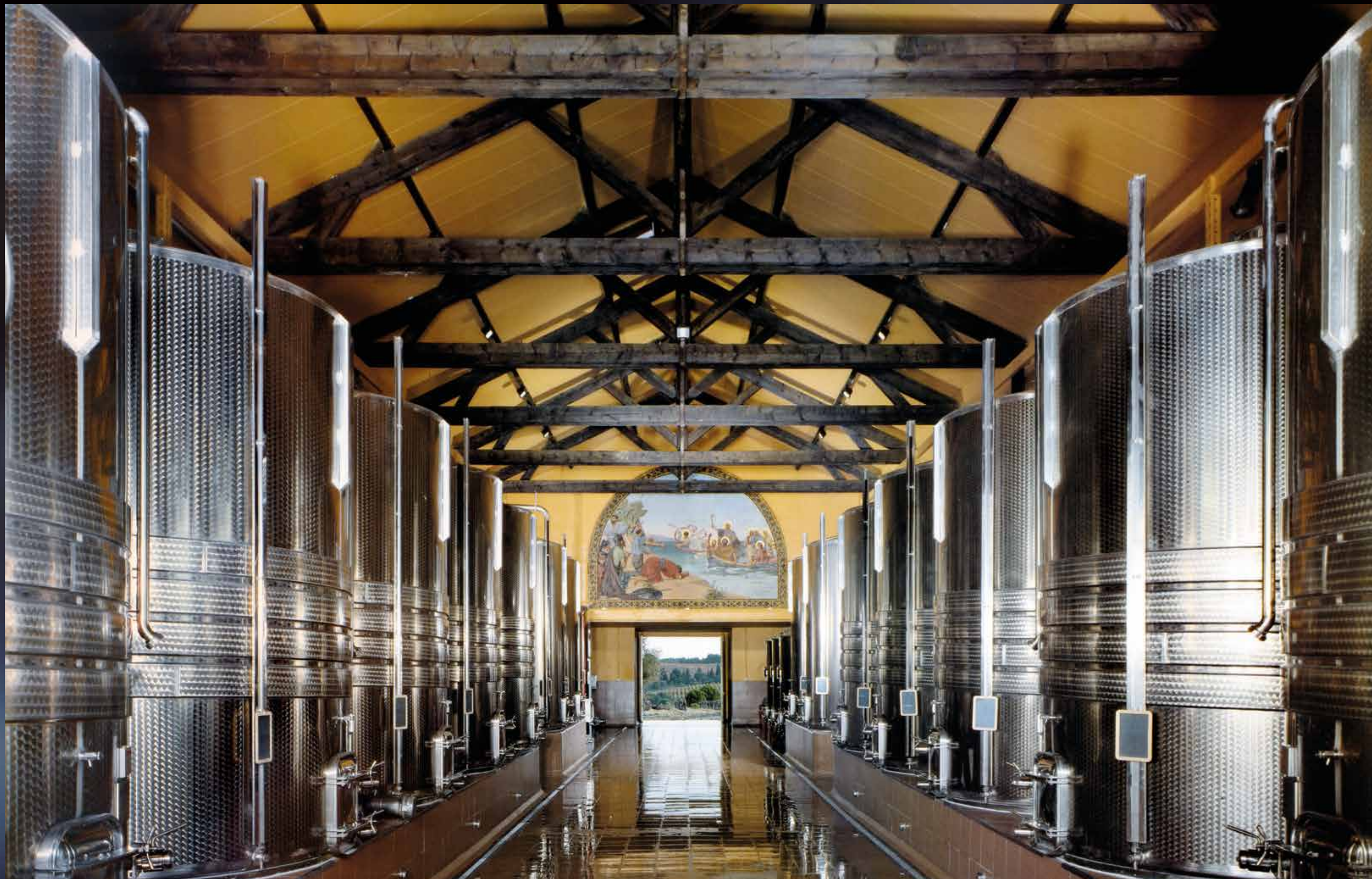
Cantina con 16 vinificatori "Normaltank" termocondizionati con intercapedine Termospiral
