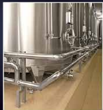
Tubi inox di collegamento
