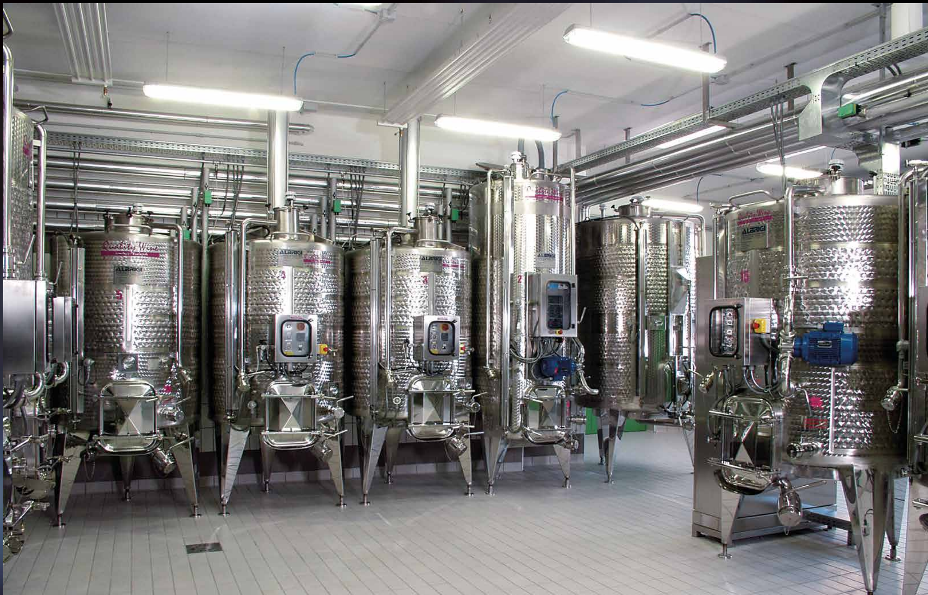
Serie di fermentatori termocondizionati con Tersmostar e completi di tutti gli accessori: Délestage - Monofolltank - Supertank - Pluviatank
