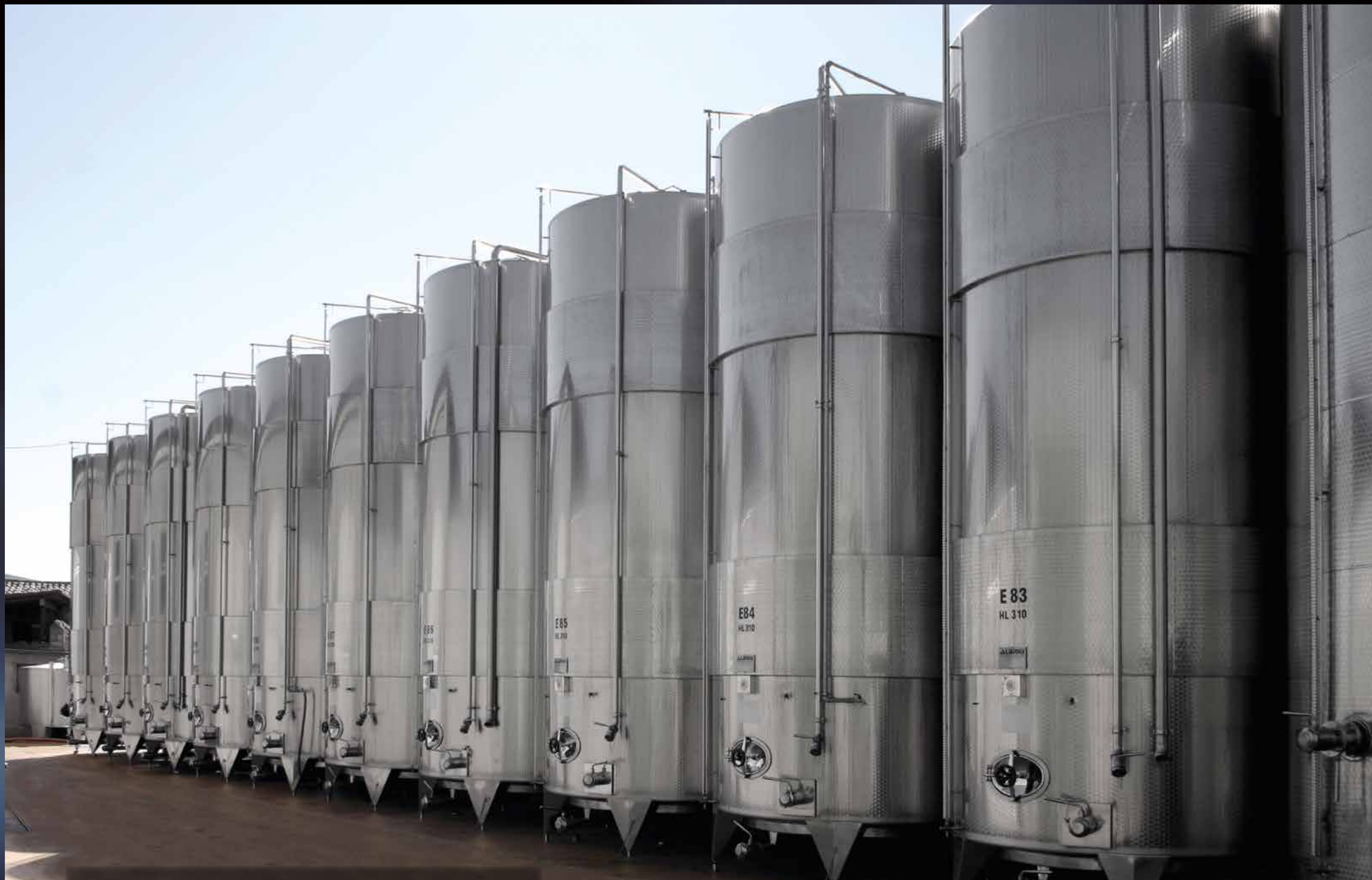
Batteria di Termotank double termocondizionati con Termostar, isolamenti sulle intercapedine Isoplus e con impianto di lavaggio Cleanfix
