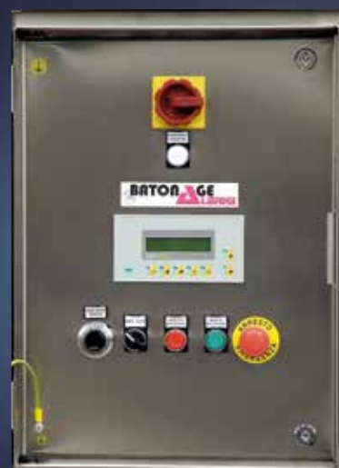
Quadro elettrico con PLC con programmi di rotazione personalizzati nel tempo
