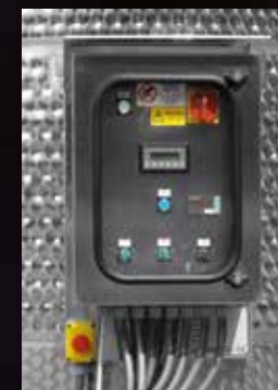
Quadro per il controllo in automatico della temperatura e di gestione dell'agitatore
