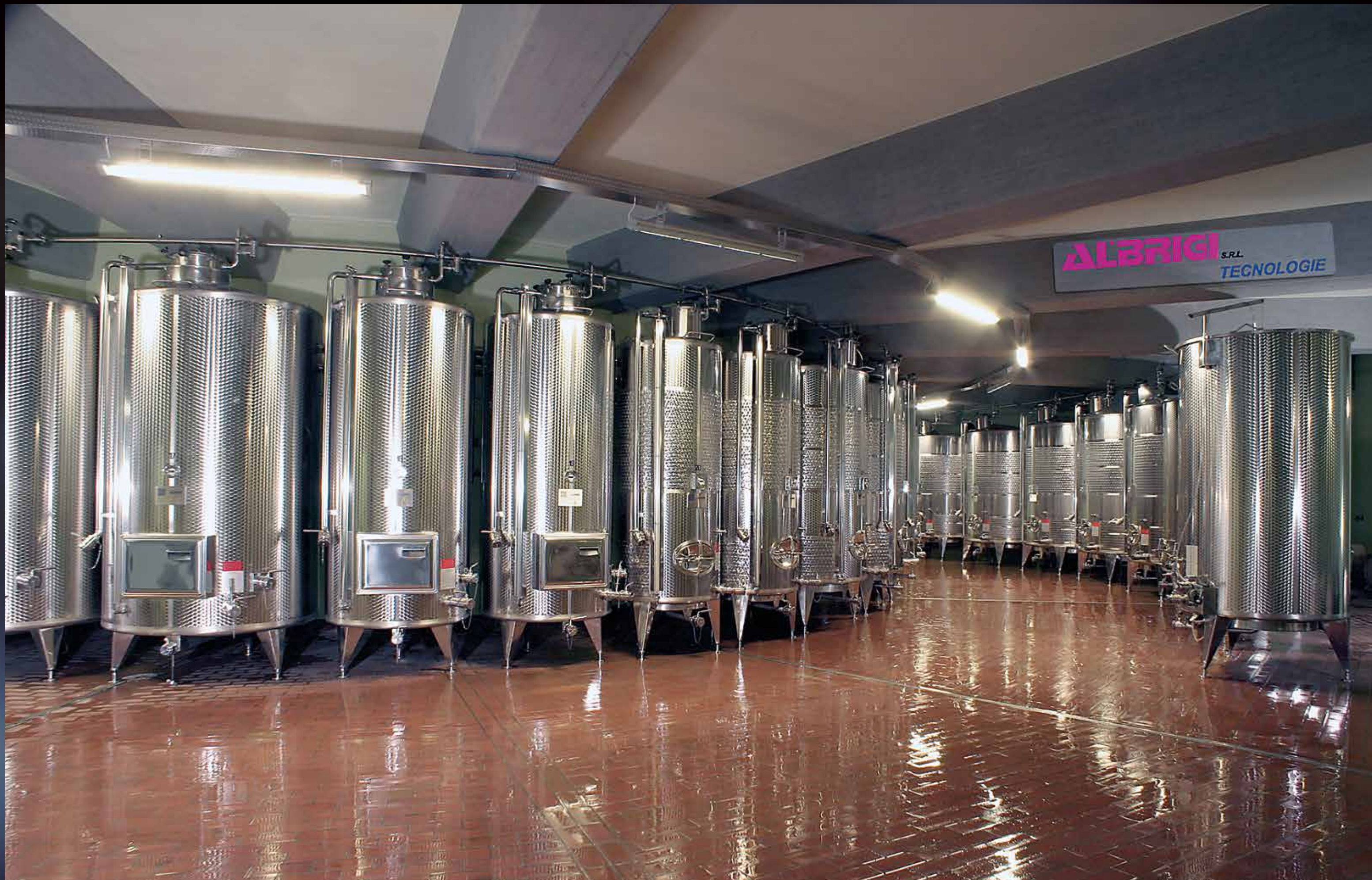
Cantina con Frigotank da 50 e 25 hl e Termotank da 100 e 50 hl
