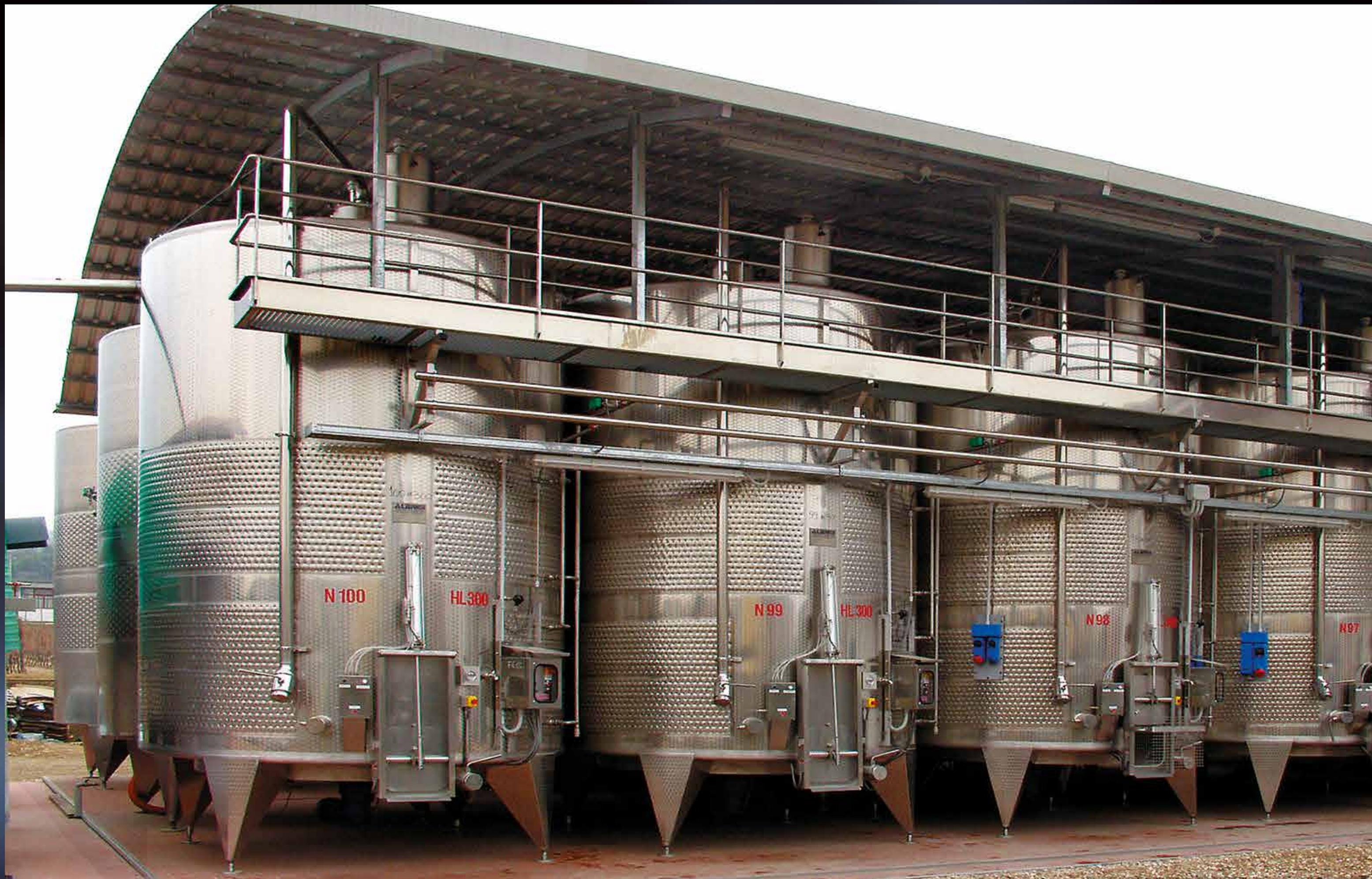
Fermentatori Meccanotank da hl 300 termocondizionati con Termostar Double con Palitank per délestage
