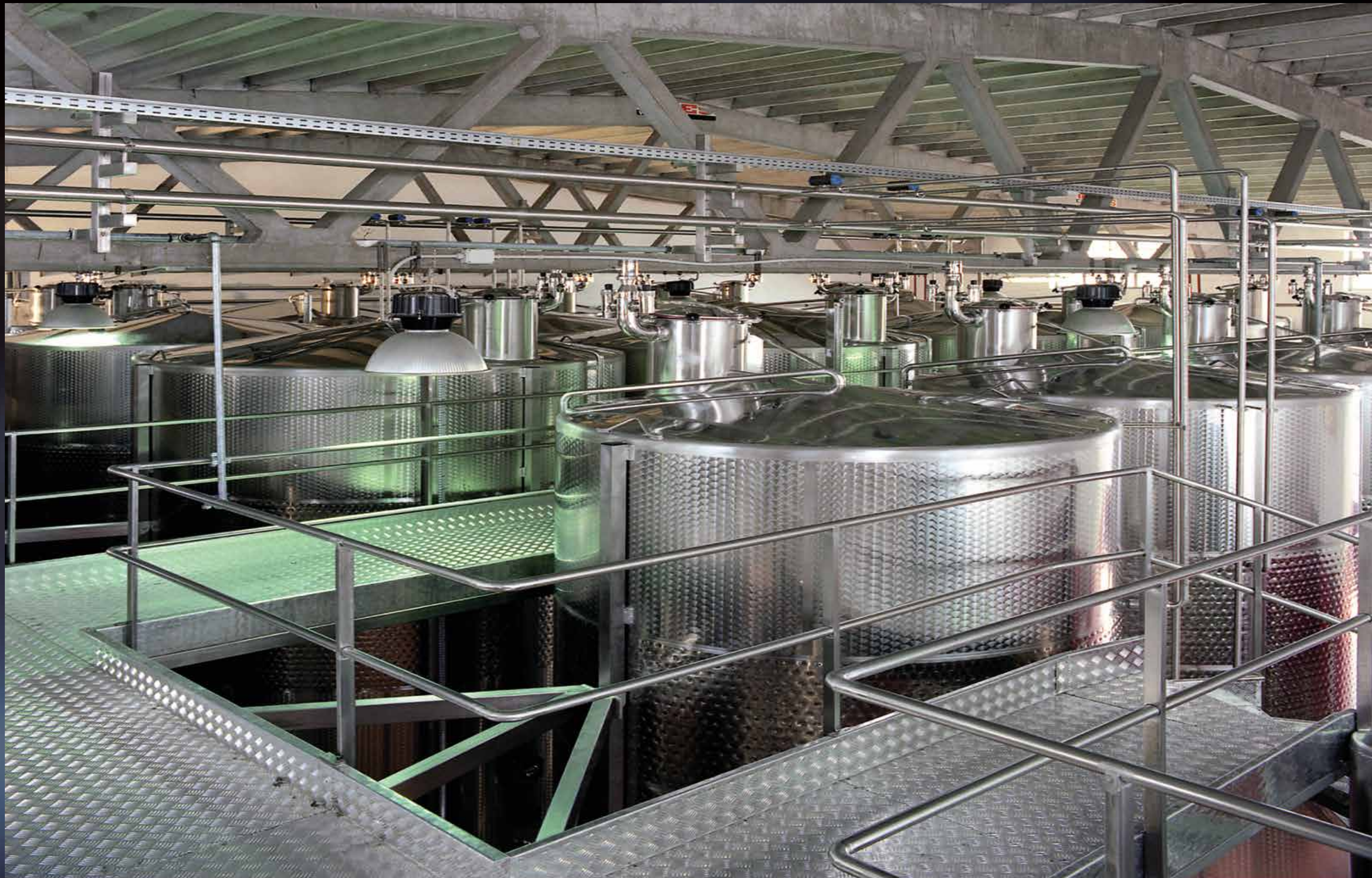
Termotank da hl 300 e hl 150 con impianto di Innergas e impianto di lavaggio Cleanfix
