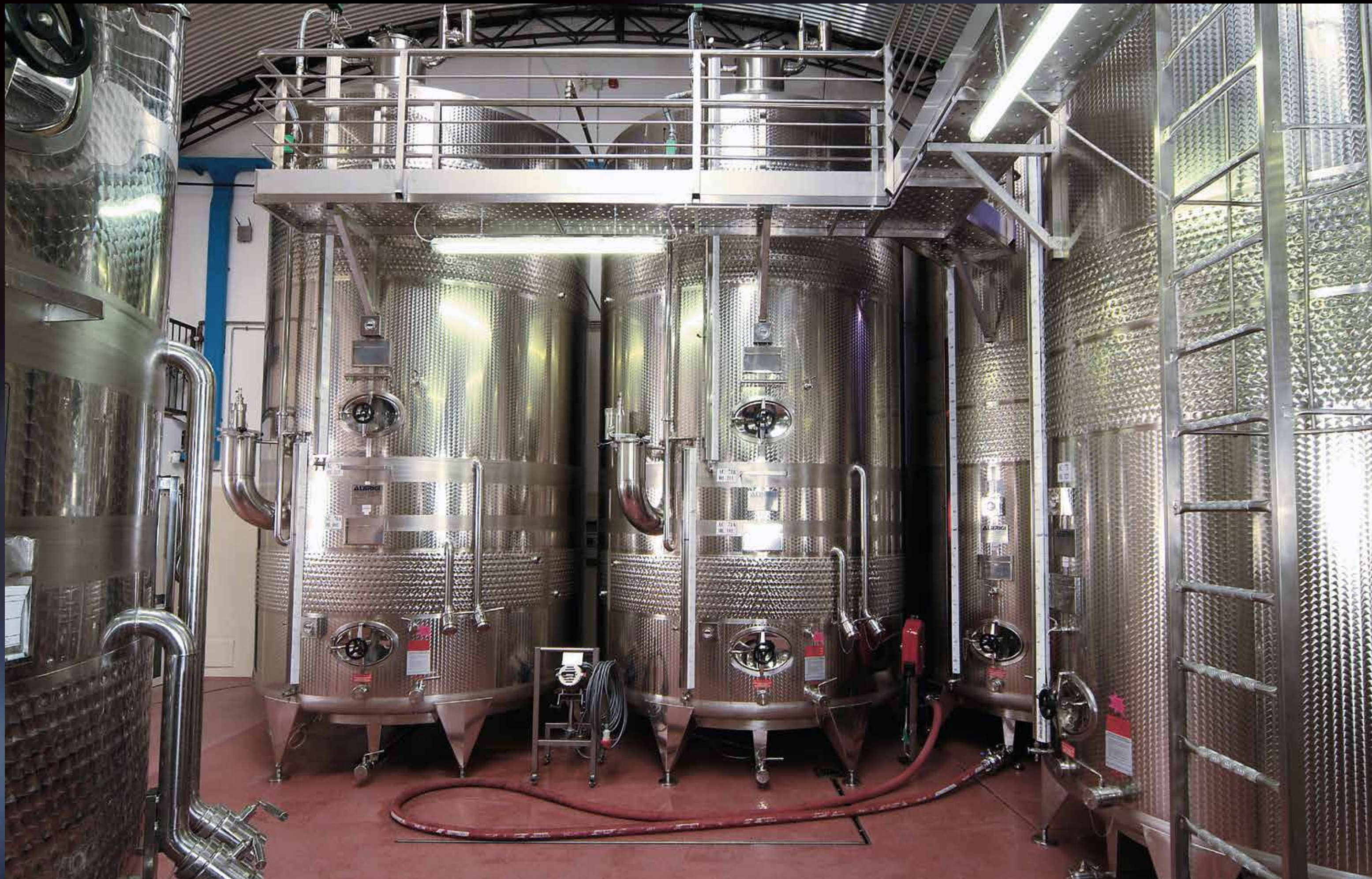
Politank da hl 100 + hl 200 termocondizionati con intercapedine Termostar, impianto di lavaggio Cleanfix e Innergas
