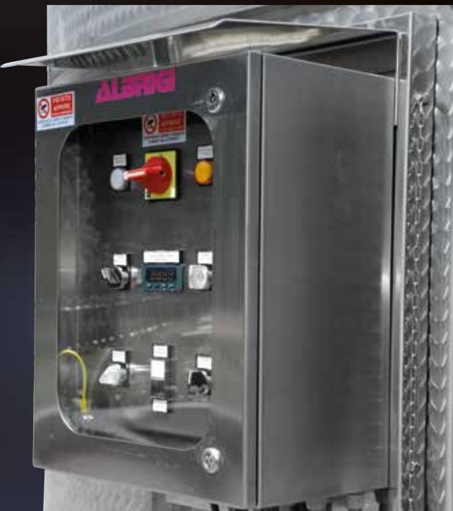
Quadro di comando in acciaio inox per Meccanotank completo di tutti gli accessori
