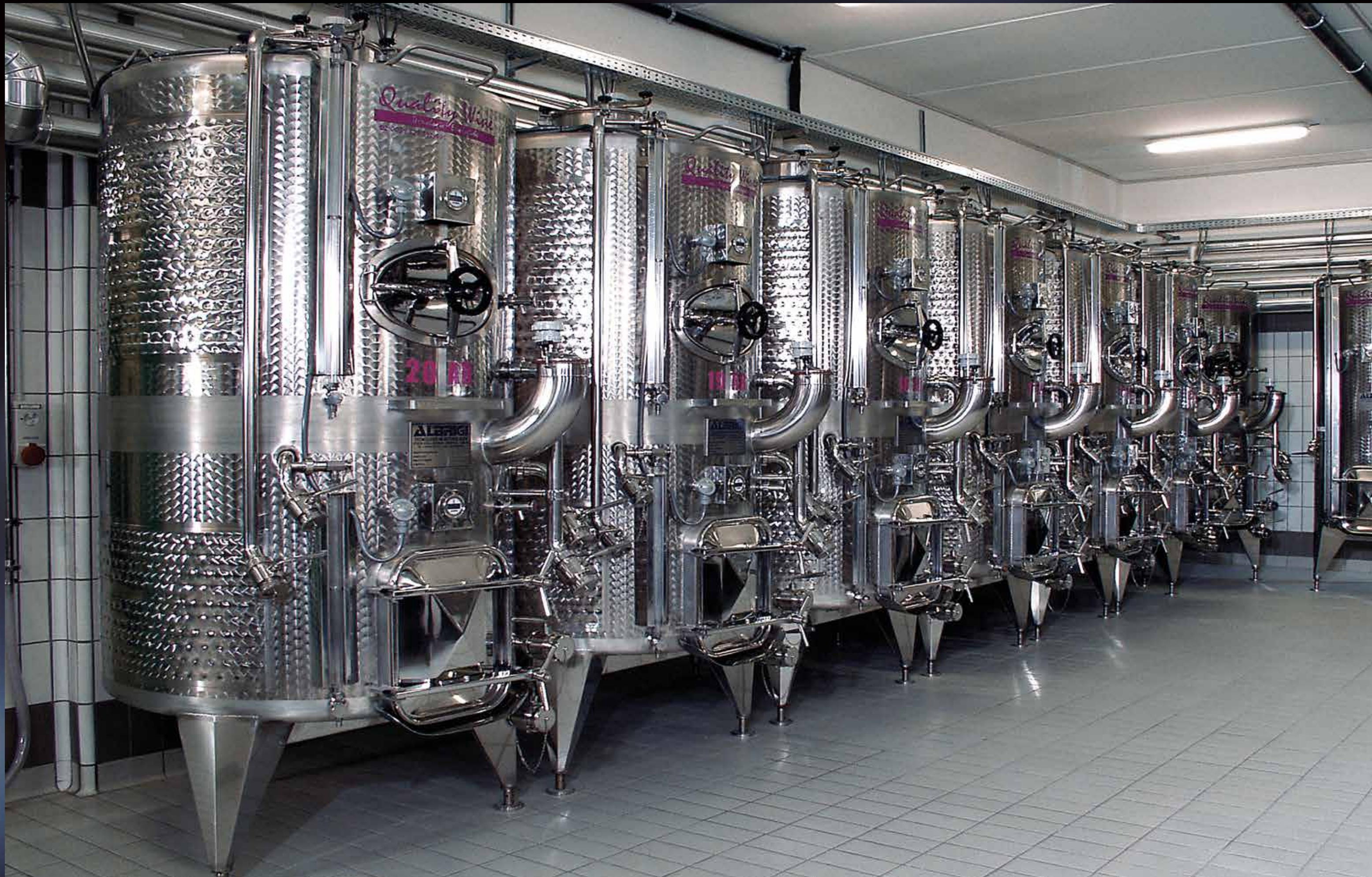
Politank Termo da hl 10 + hl 15 termocondizionati con Termostar, impianto di lavaggio Cleanfix e impianto Innergas con scomparto inferiore utilizzato per la fermentazione scomparto superiore utilizzato per lo stoccaggio
