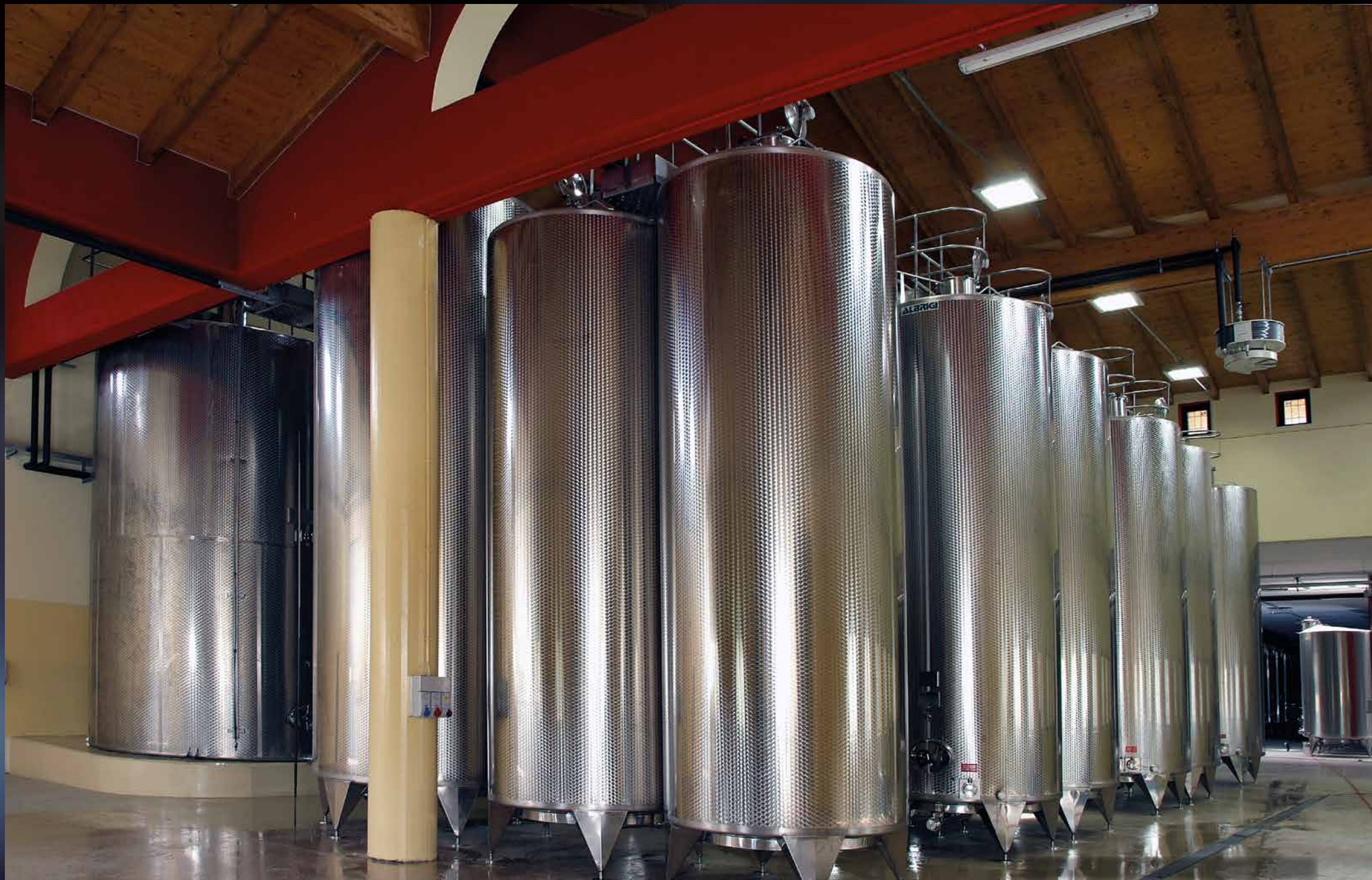
Vinotank da 150 e 600 hl con passerelle di servizio e pianerottolo di accesso ad ogni chiusino
