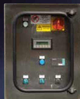
Quadro di comando della temperatura e dei rimontaggi automatici
