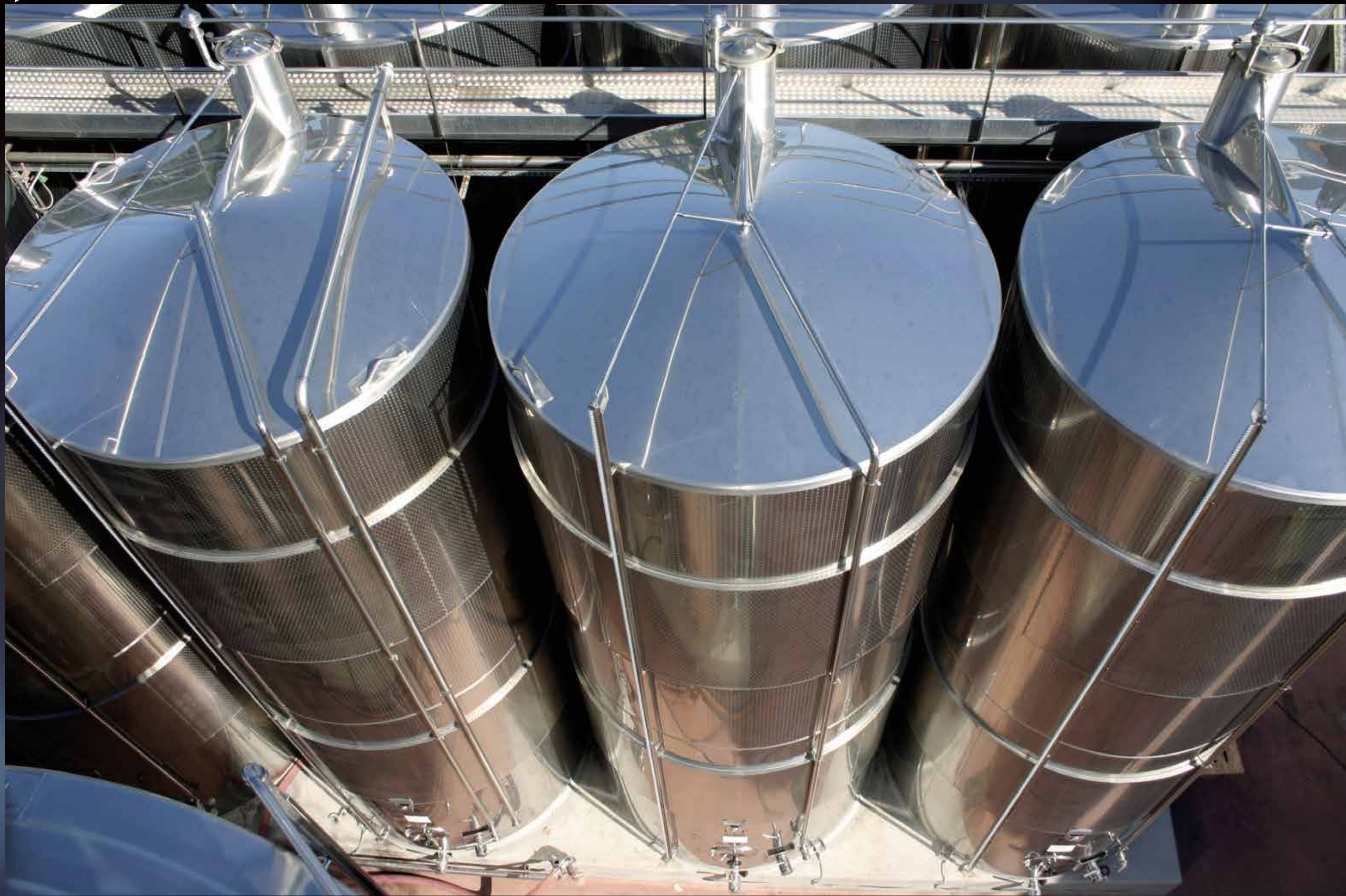
Megatank da hl 600 termocondizionati con Termostar Double, isolati con Isoplus e impianto di lavaggio fisso Cleanfix
