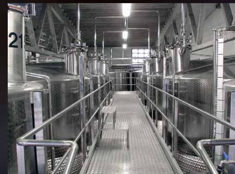
Passerella con serbatoi da hl 300 con gruppo di sicurezza e impianto fisso di tubi inox Innerpipe
