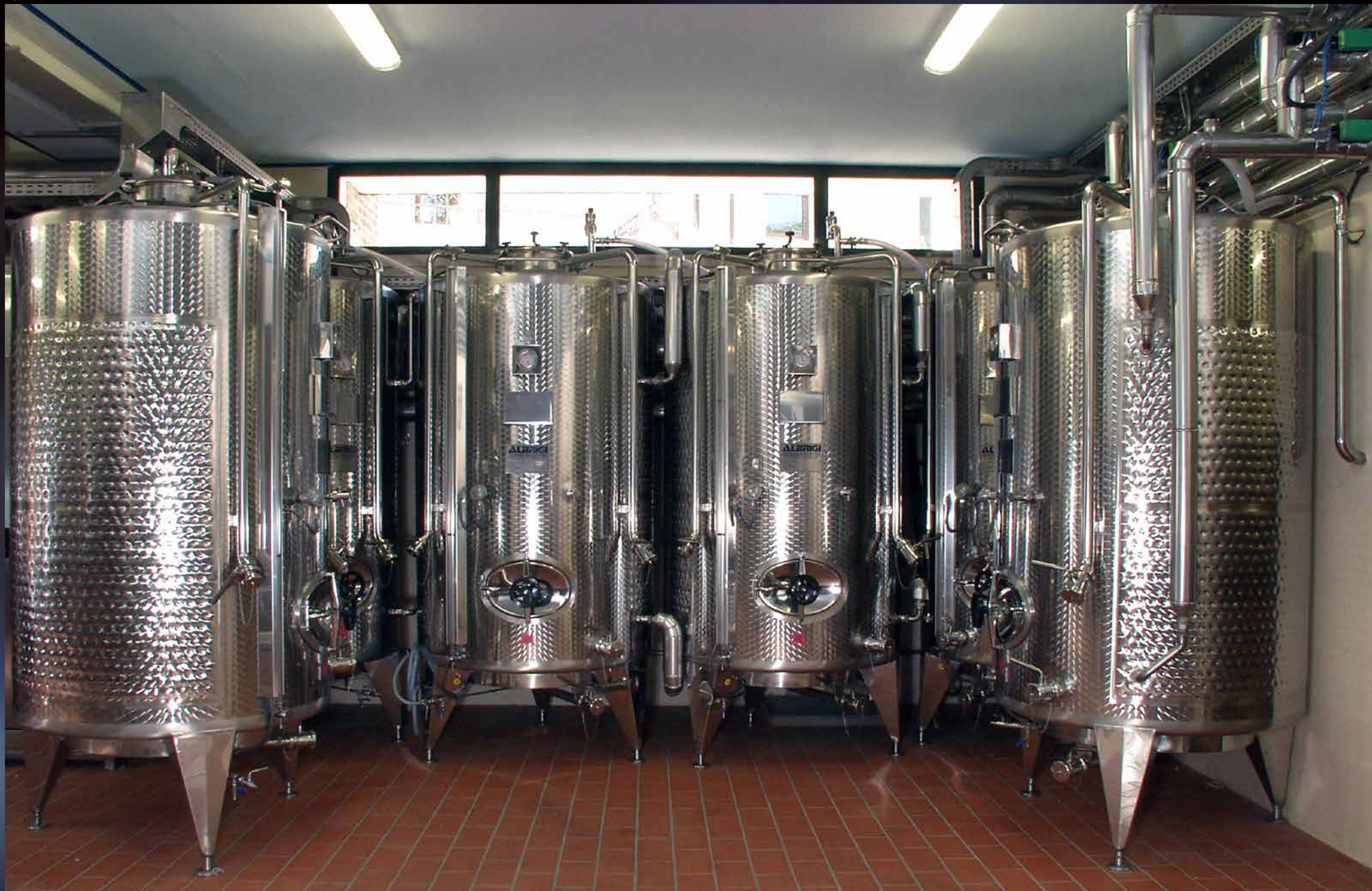
Reparto di stoccaggio predisposto di serbatoi con intercapedini Termostar per eseguire la fermentazione malolattica con Innergas
