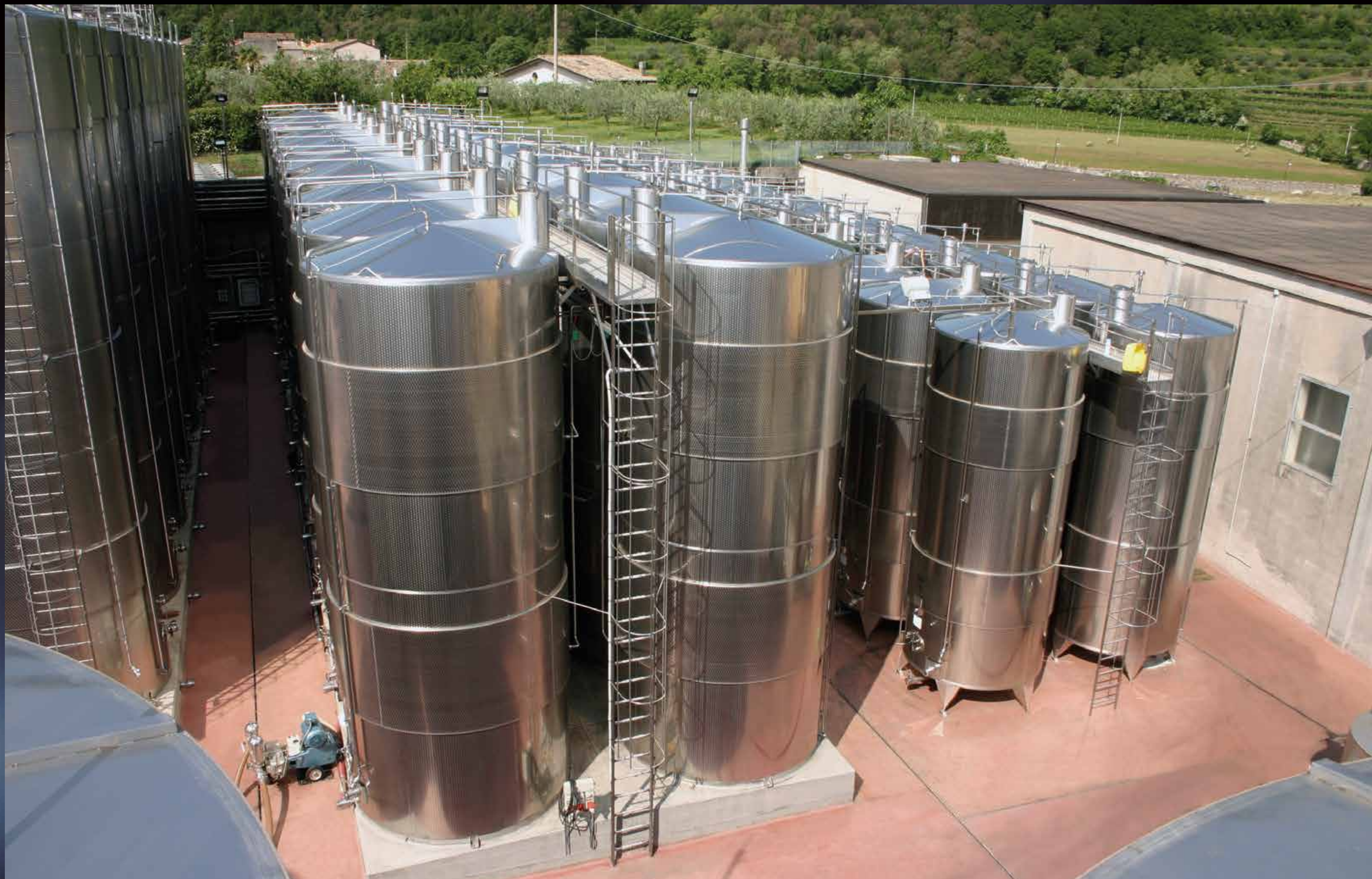
Megatank da hl 600 e hl 300 termocondizionati con Termostar Double, isolati con Isoplus e impianto di lavaggio Cleanfix
