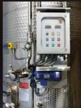
Quadro elettrico di gestione della pompa di rimontaggio o delle fasi di follatura
