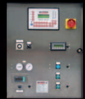
Quadro elétrico para recalgador
