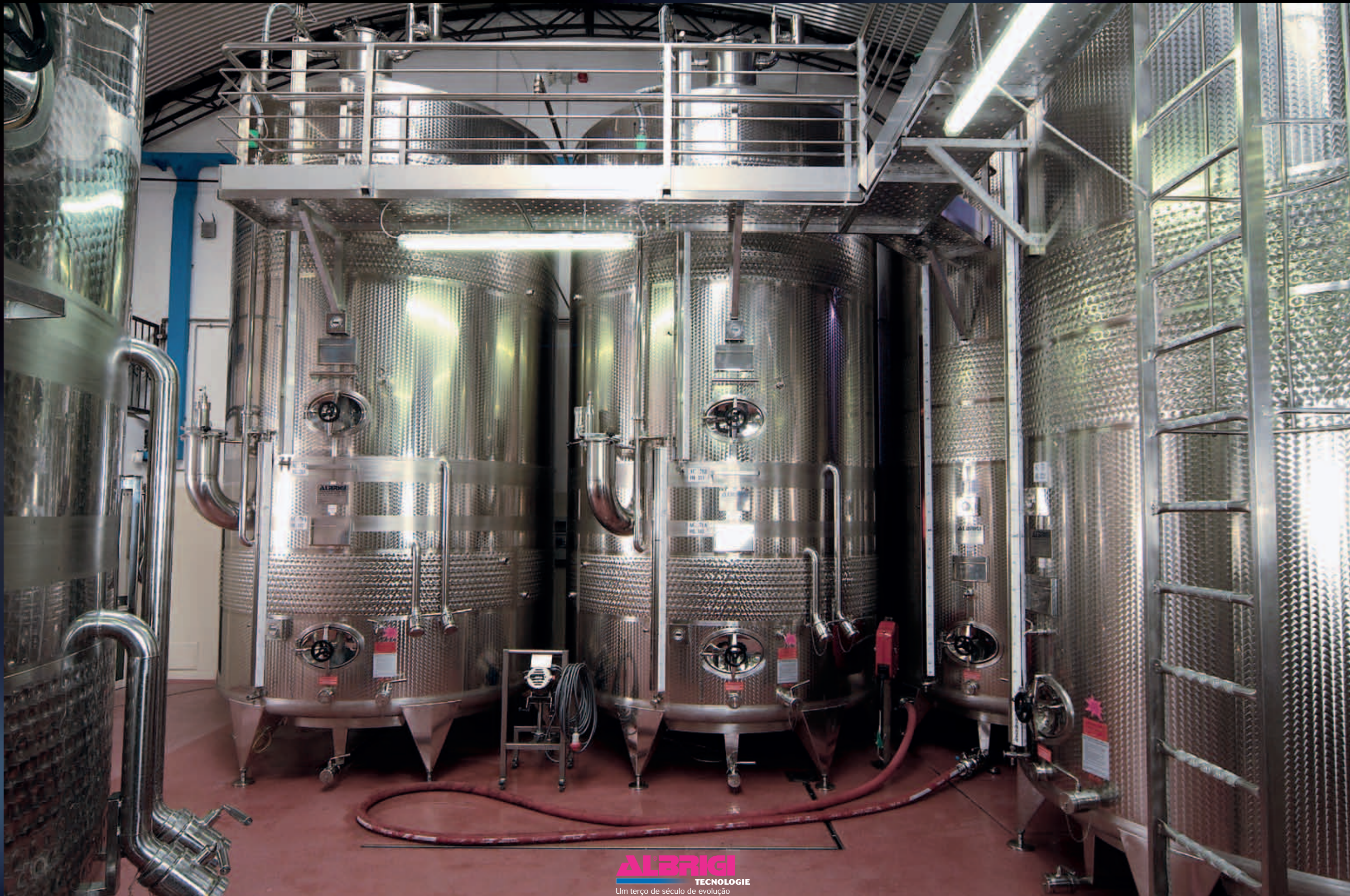
Tanques Politank camisa de 100 hl + 200 hl termocondicionados com Termostar, instalação de lavagem Cleanfix e Innergas
