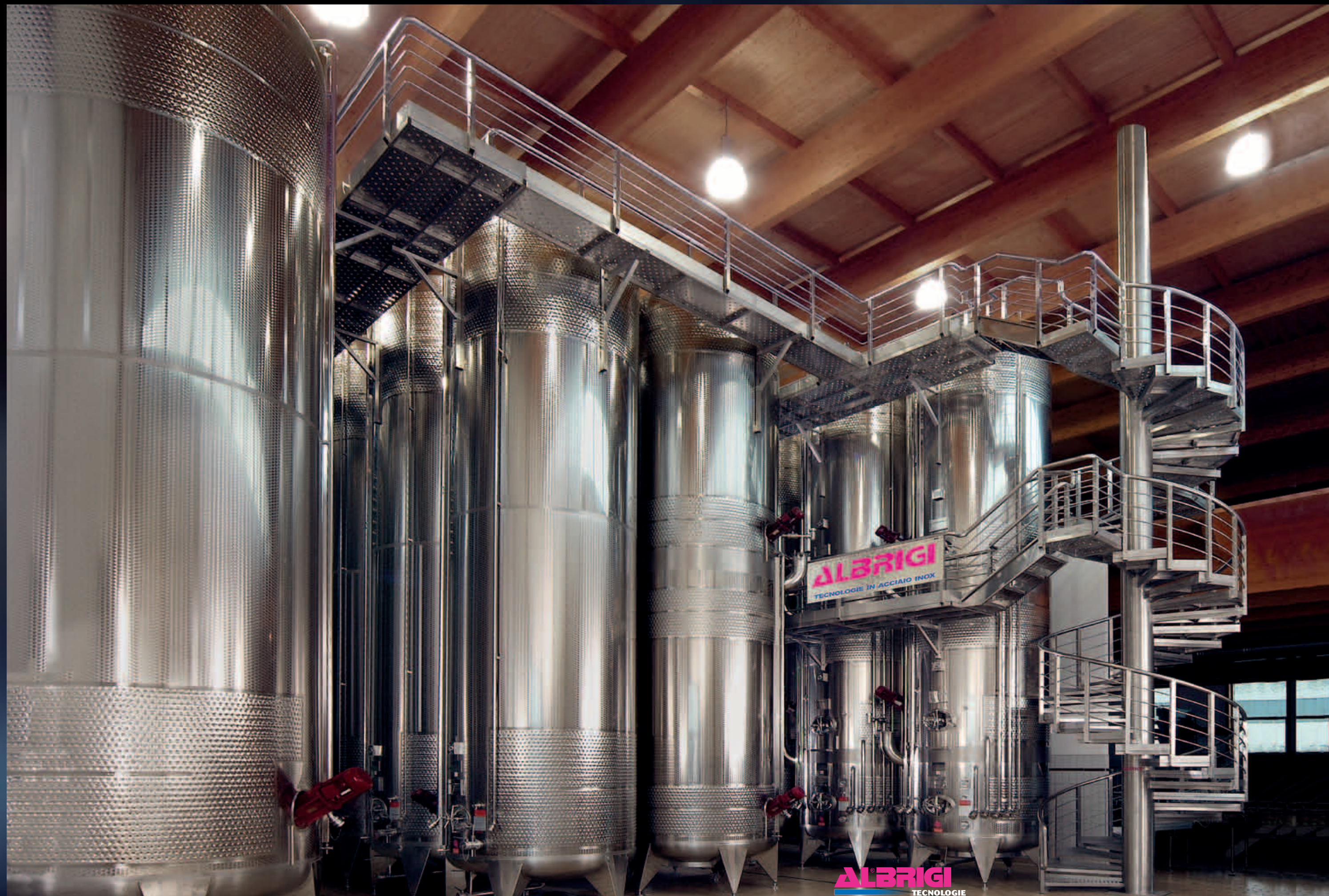
Vinícola de estocagem com tanques Bigtank Termo de 600 hl e 300 hl e Politank Termo de 150 + 150 hl i 200 + 100 hl e 50 + 50 + 100 hl, todos termocondicionados com Termostar, instalações de lavagem Cleanfix e instalações Innergas
