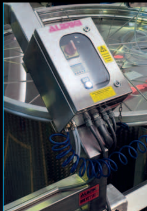
Quadro de comando eletropneumático de subida e descida manual/automática
