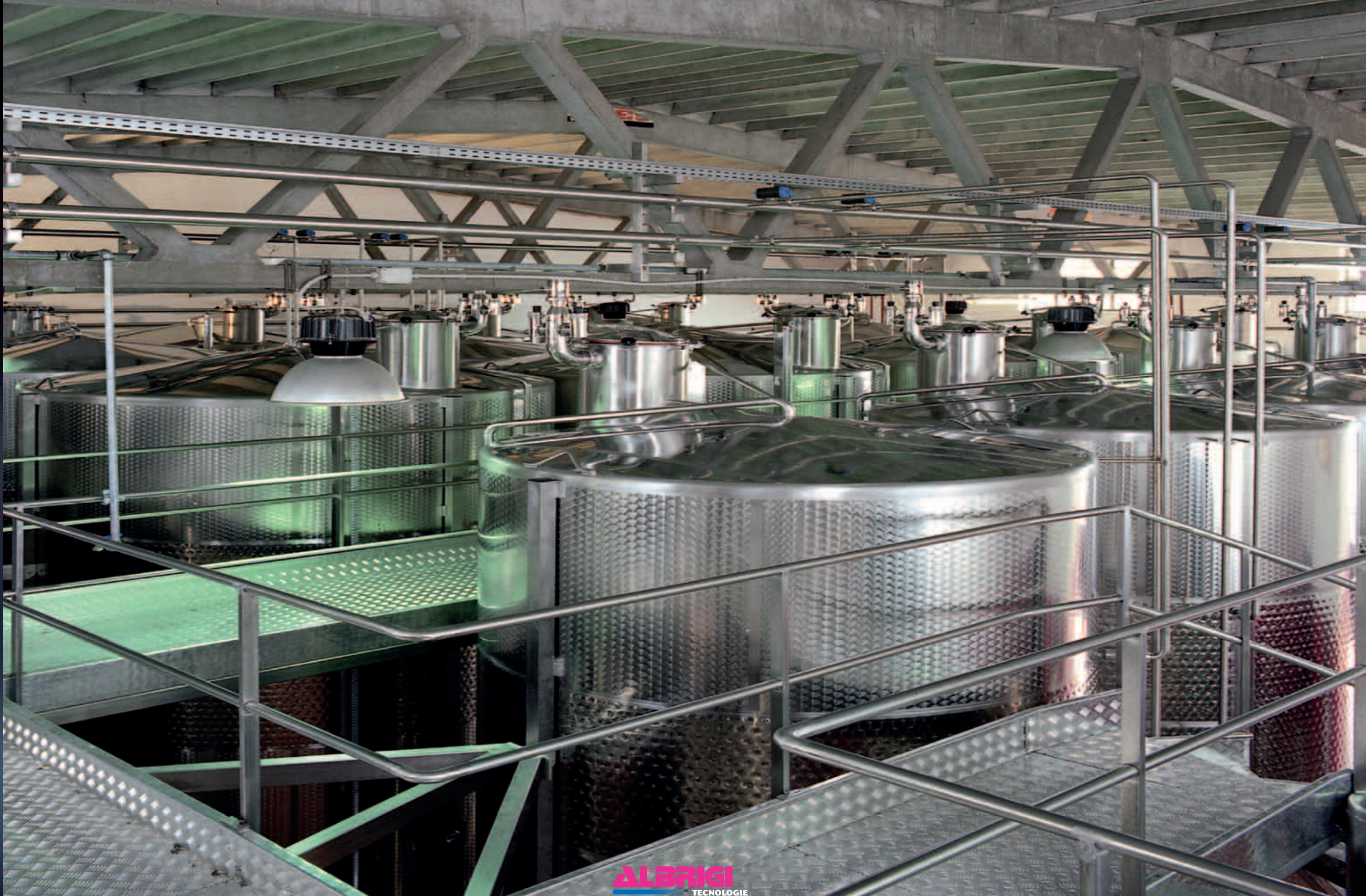
Tanques Termotank de 300 hl e 150 hl com instalação Innergas e instalação de lavagem Cleanfix
