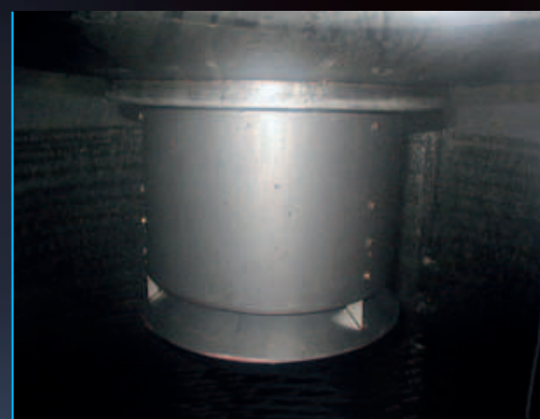
Vista de baixo da válvula de cascata com o canalizador fechado
