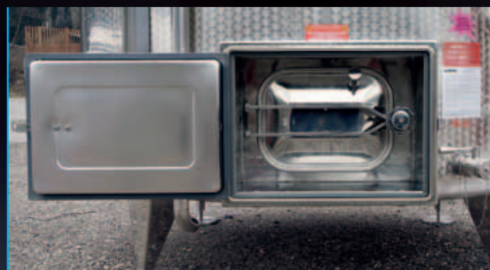
Porta retangular e contraporta isolada com a descarga da água de condensação
