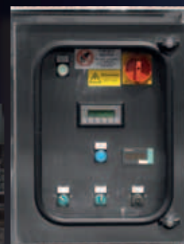
Quadro de comando da temperatura e das remontagens automáticas
