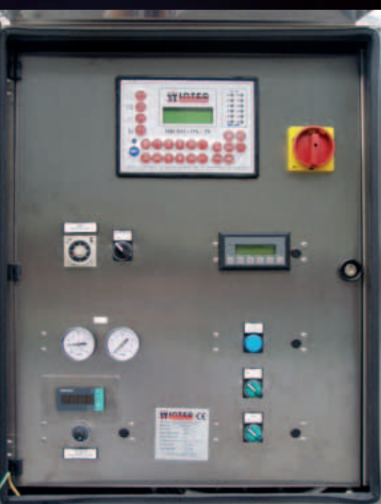
Quadro com a central de oxigenação
