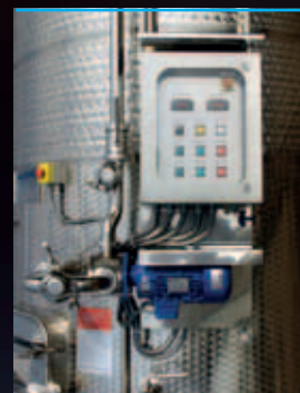
Quadro elétrico de gerenciamento da bomba de remontagem ou das etapas de recalque
