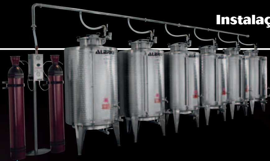
Bateria de tanques sob azoto com Innergas para a armazenagem de vinho avulso
