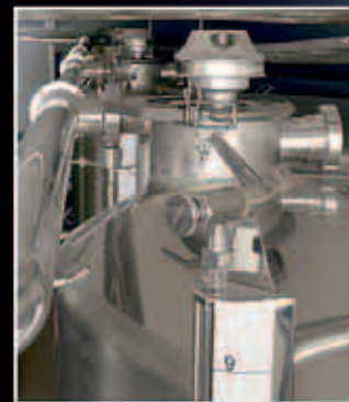
Mannloch mit Entlüftung
