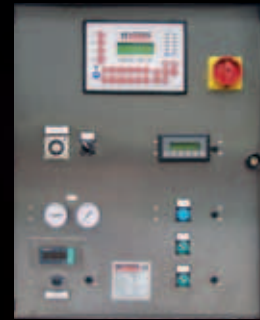
Schalttafel für Unterstoßmechanismus
