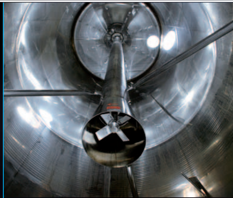
Anbringung einer Turbotank-Vorrichtung im Inneren eines Gärtanks mit 1.000 hl Fassungsvermögen
