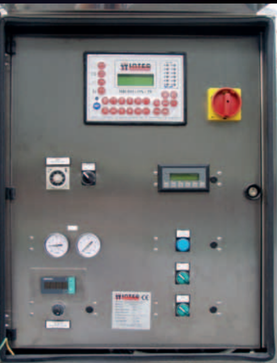
Schalttafel mit Sauerstoffanreicherungssteuerung
