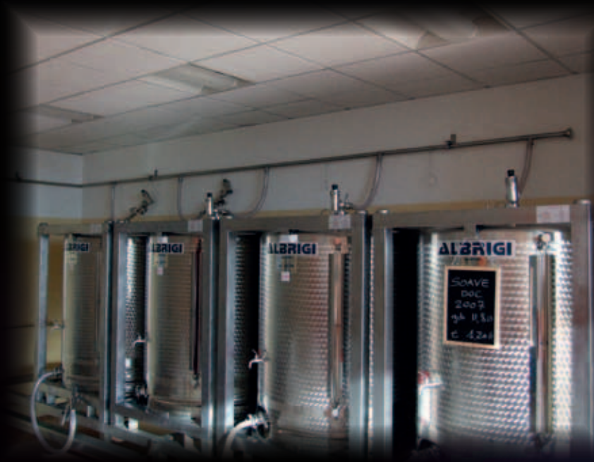
Lageranlage für den Verkauf von offenem Wein mit Stickstoff-Inertisierungsanlage
