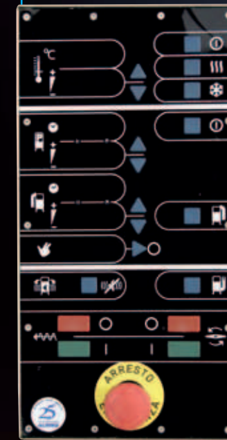
Schalttafel mit SPS
