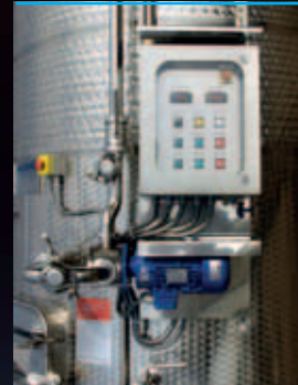
Schalttafel zur Steuerung der Remontage- Pumpe oder der Unterstoßphasen
