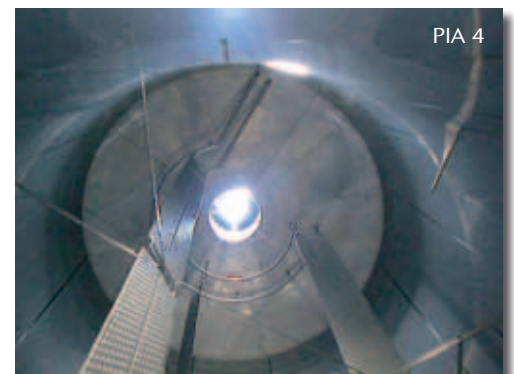
Vista di grappolo di Termoplaestre con collettore di alimentazione interno
