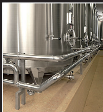
Tubi inox di collegamento
