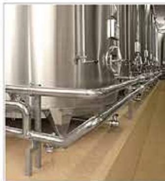
Tubi inox di collegamento Stainless steel piping
