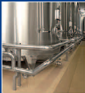
Tubi inox di collegamento Stainless steel piping
