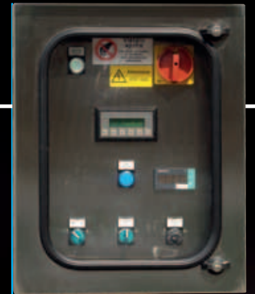
Quadro per il controllo in automatico della temperatura e di gestione dell'agitatore
