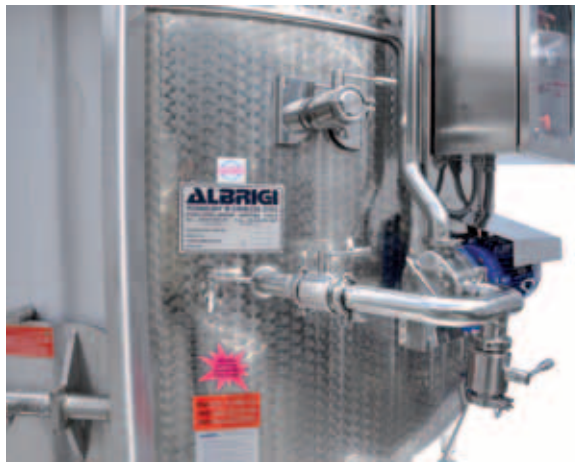
I Pompa di rimontaggio collegata al tubo di rimontaggio con il quadro elettrico
