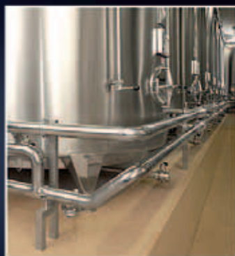
Tubi inox di collegamento Stainless steel piping
