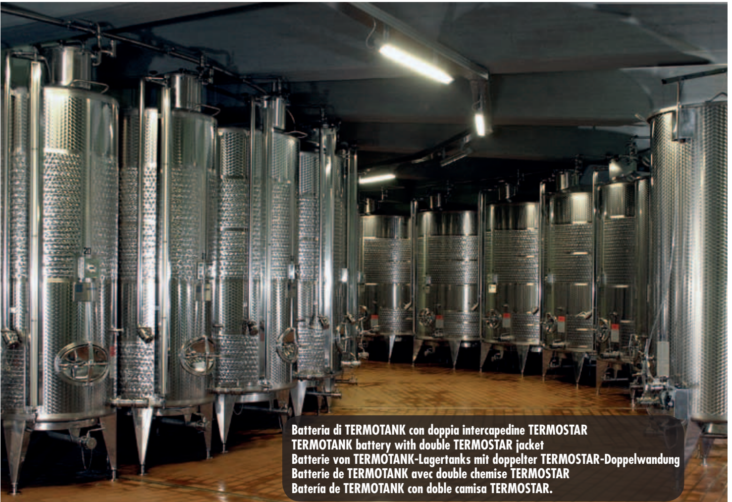
Batteria di TERMOTANK da hl 300 e hl 150 con intercapedine TERMOSTAR 300 hl and 150 hl TERMOTANK battery with TERMOSTAR jacket Batterie von TERMOTANK-Lagertanks, 300 hl und 150 hl, mit TERMOSTAR-Doppelwandung Batterie de TERMOTANK de 300 et 150 hl avec chemise TERMOSTAR Bateria de TERMOTANK de 300 hl y 150 hl con camisa TERMOSTAR.
