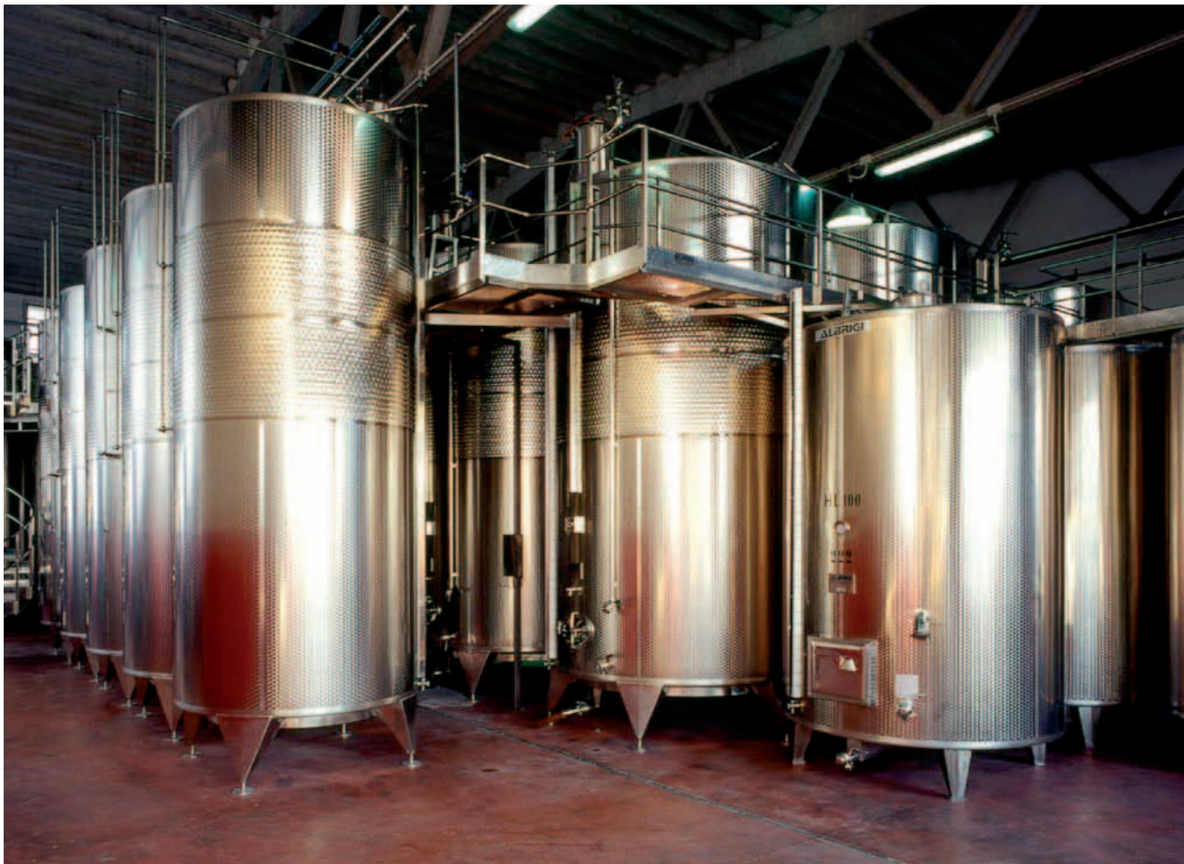
Batteria Termotank da lt 30.000 e lt 15.000 e Frigotank da lt 10.000
