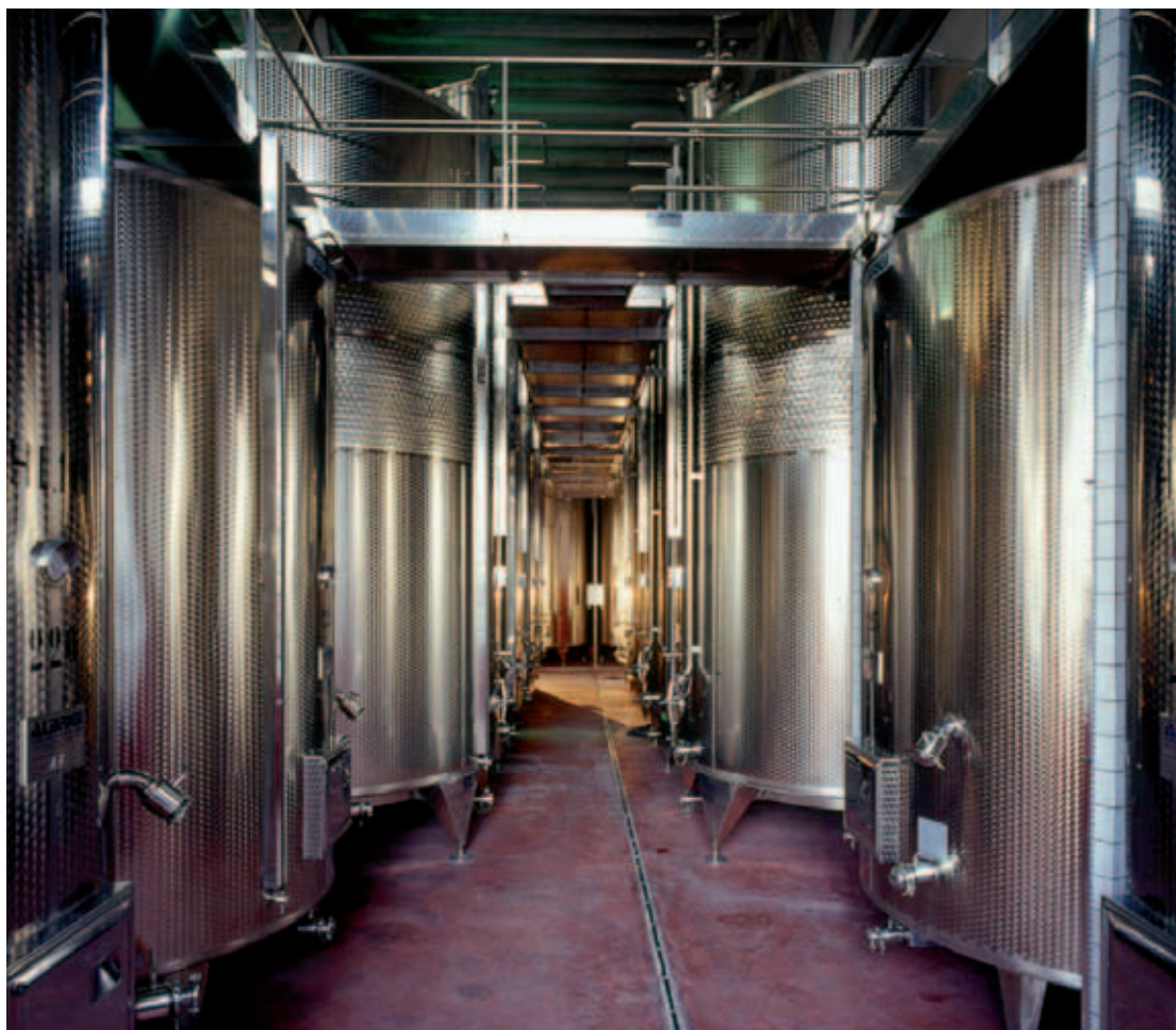
Batteria TERMOTANK da lt 30.000 e FRIGOTANK da lt 10.000
