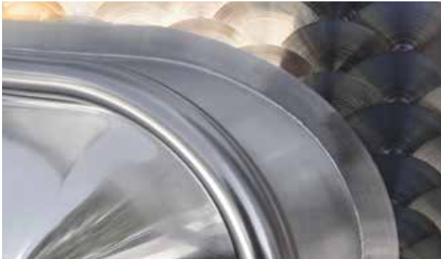
External manual TIG welding of hatch Saldatura esterna a TIG manuale di portella
